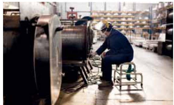
ICI Caldaie S.p.A., Zevio (VR)
