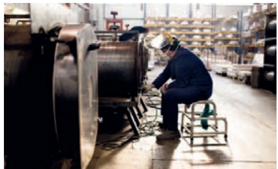
ICI Caldaie S.p.A., Zevio (VR)
